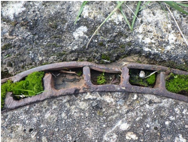
Tampon cassé – RV 891
