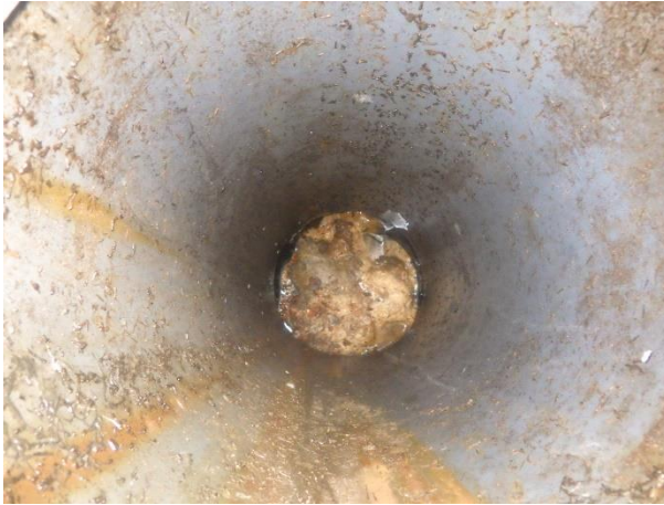
Branchement 3003 obstrué – Les Varennes
