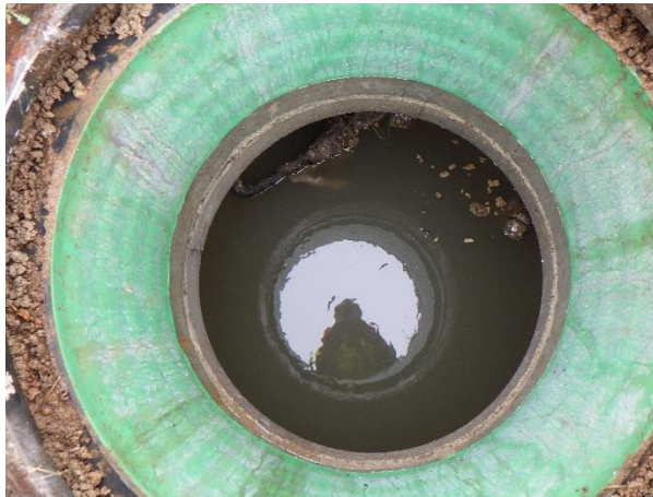
Mise en charge – Amont STEU
