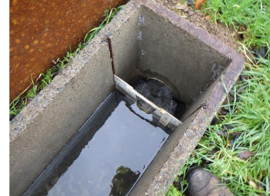
Effluent clair en sortie
