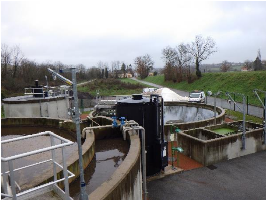
Bon fonctionnement général du site, prétraitements OK et bon entretien des abords
