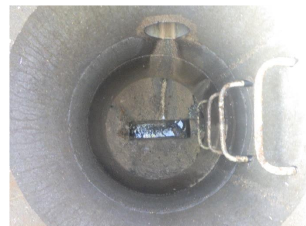
Radier fissuré – Intrusion – RV 3166 (Manitowoc)
