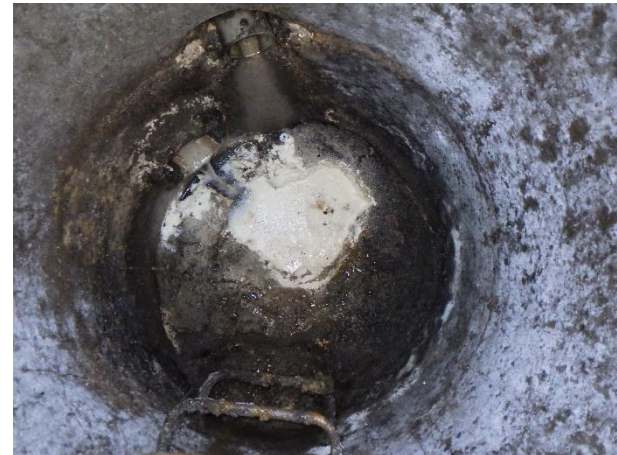
Mise en charge – Rue Magellan (aval Boizet)
