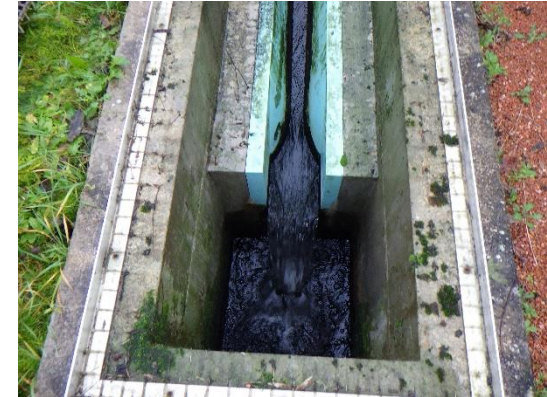
Effluent clair en sortie
